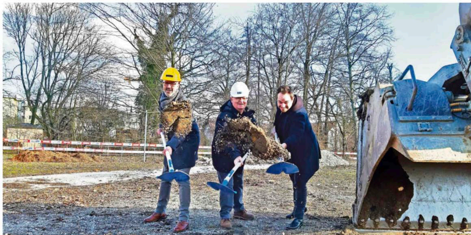
Nach dem Spatenstich von André Ingold, Jürgen Besmer und Benjamin Widmer (von links) gingen die Aushubarbeiten gleich weiter. Die Fertigstellung des Speichers ist für Ende Mai 2023 vorgesehen.
